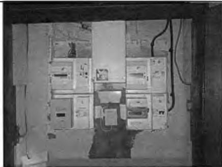
Photo du Compteur électrique
